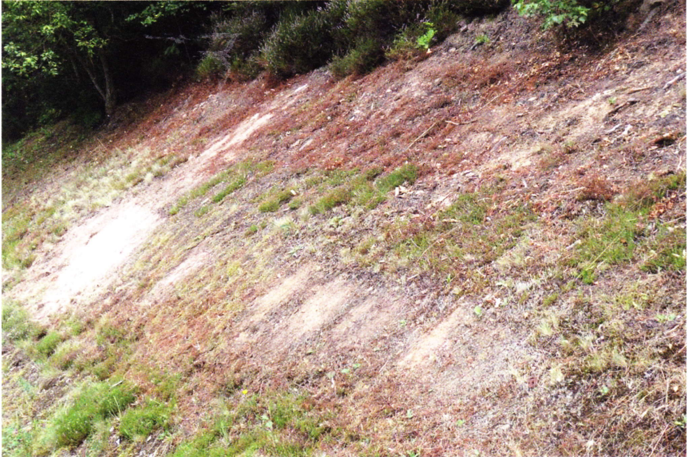
Abb. 3: An dieser Böschung im Heinrichsthaler Forst wurden alle Strukturen bis auf die Bodennarbe beseitigt. Foto: R. Malkmus.
