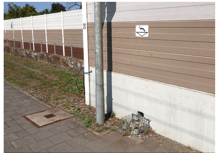
Abb. 120: Lärmschutzwand am Bahnhof Retzbach mit Durchlass für Eidechsen am 2.9.2024.
